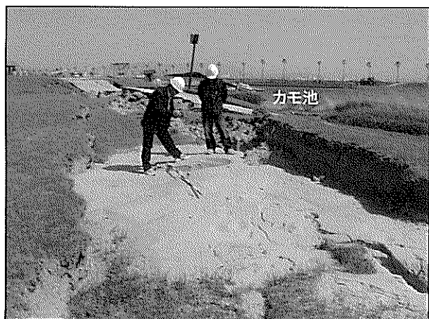
写真-2 カモ池周辺に発生した液状化に伴う亀裂群
