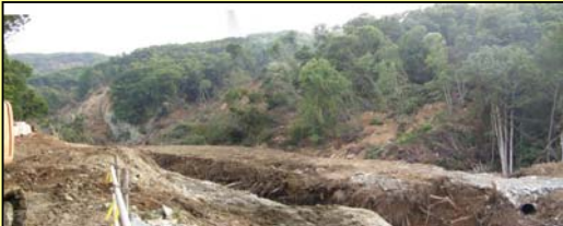
③(一関市厳美町市野々原:国道沿い) 地質境界沿いの斜面崩壊
