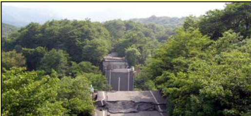
①(一関市厳美町祭時:祭時大橋) 鋼桁橋(L=94m)の落橋(1978年完成)
