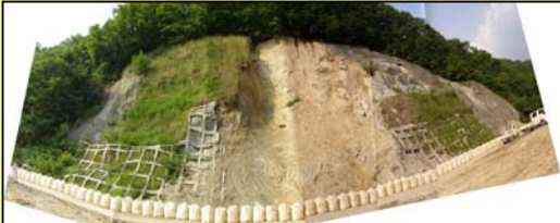
②(一関市厳美町市野々原:国道沿い) 地質境界沿いの斜面崩壊
