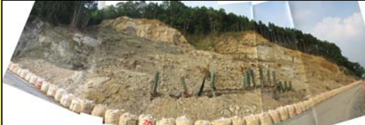
⑤(一関市厳美町市野々原:国道沿い) 地質境界沿いの斜面崩壊
