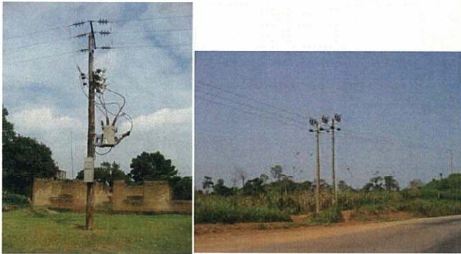
図14 左：再閉路装置（ウガンダ）、右：気中開閉器（ガーナ） Figure 14. left: Pole-mounted Recloser (Uganda), right: Load Break Switch (Ghana)
