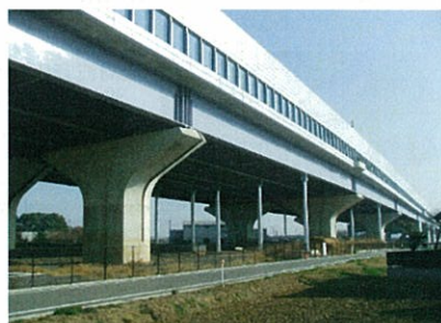
写真-5 センターダンパー全景
