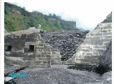
写真-3 摩耗による損壊事例
