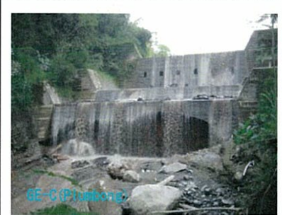
写真-2 河床変動による損壊事例
