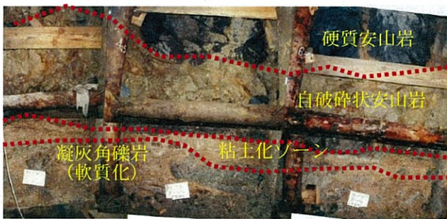
図-4.1 横坑TL-2坑における軟弱層
