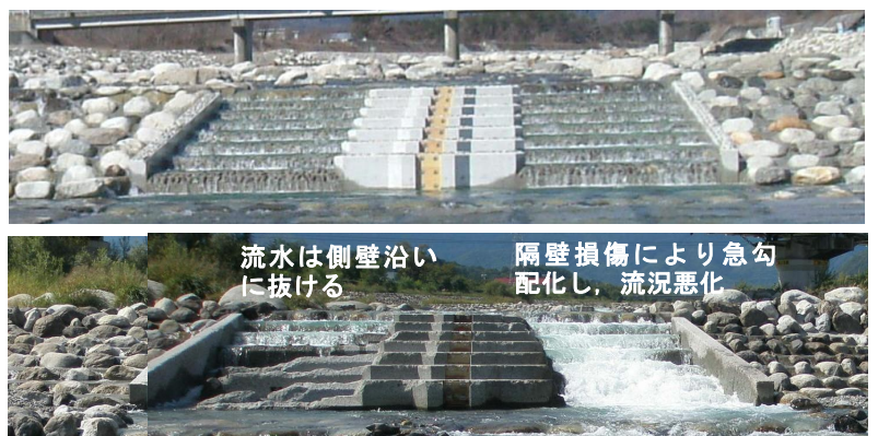
写真-1 隔壁損傷状況（第49号床固工）
