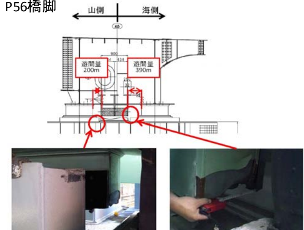
図-18 落橋防止構造の損傷状況 (P56L 拡幅部)
