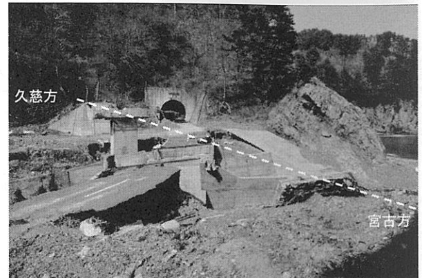
図-7 ハイペ沢桥梁の被災状況
