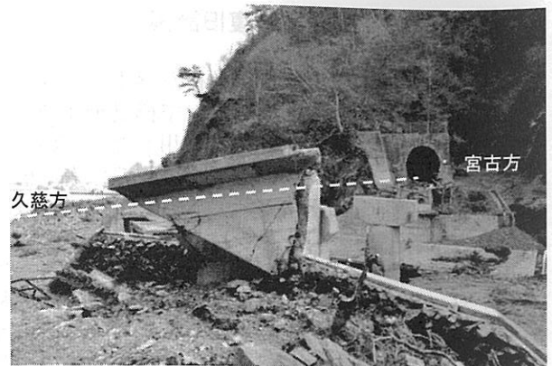
図-6 コイコロベ沢桥梁の被災状況
