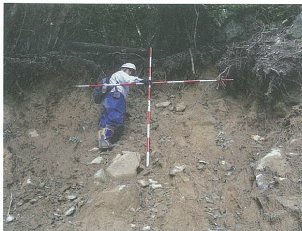
写真-7 五反田川の源頭部の崩壊状況
