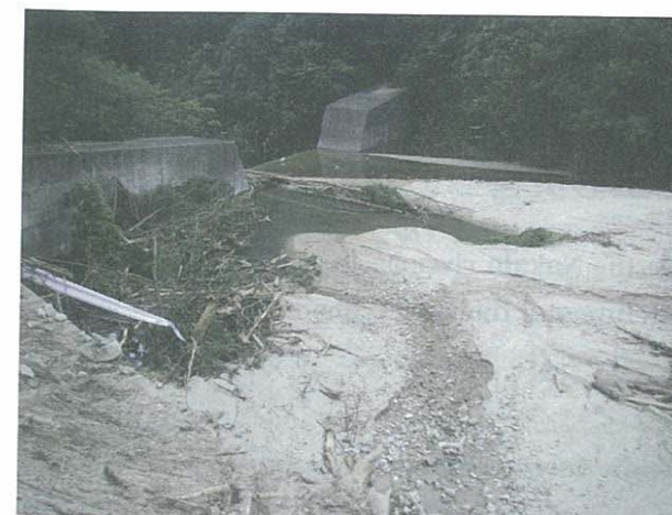
写真-17 砂防堰堤の堆砂状況 （安佐北区大林3丁目、下ノ谷川）
