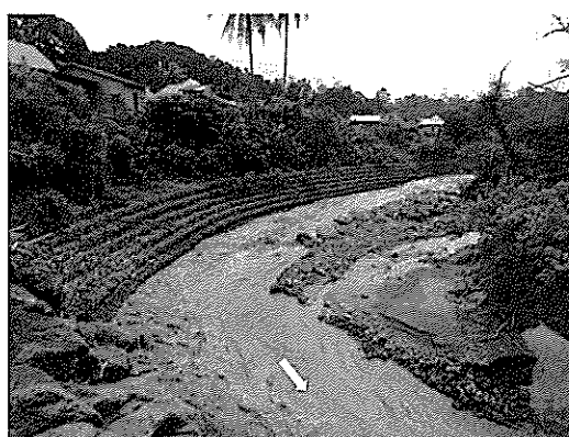
写真-11 ボルス川に緊急的に設置した護岸工 [Jandimeriah 付近] (2015年12月3日撮影: 図-2 ⑪地点)
