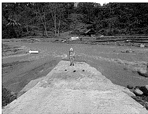
写真-10 ボルス川に緊急的に設置した砂防堰堤 [Selandi 付近] (2015年12月3日撮影: 図-2 ⑩地点)
