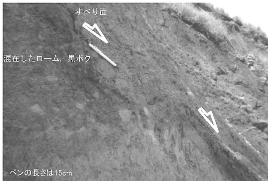
写真-4 過去の斜面変動により混在したローム、黒ボク(位置は口絵図-3に示す)
