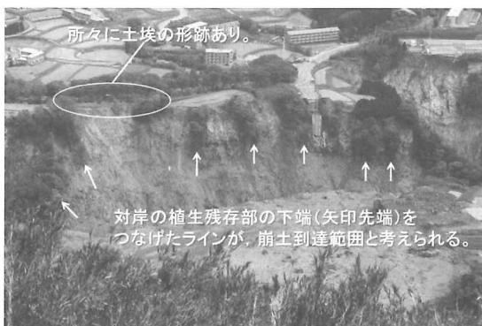
写真-2 対岸の黒川河岸の植生破壊状況
