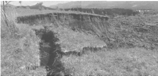
写真-3 地すべり①頭部の滑落崖と背後のクラック(位置は口絵図-3に示す)
