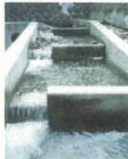
写真-2 魚道出口の堆砂
