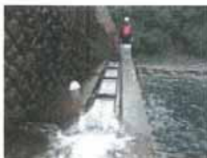
写真-5 魚道入口の 堆積土砂
