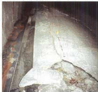
写真-1 盤膨れの状況。トンネル底盤で約20cmの隆起が確認される。
