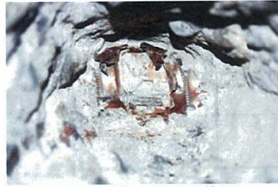
写真-7 PC鋼材のゆるみ箇所
