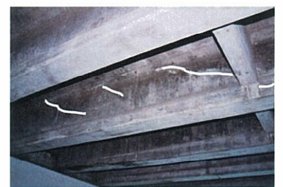
写真-2 主桁ウェブひび割れ
