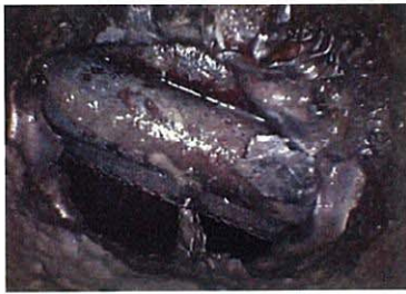
写真-6 グラウト充填不足
