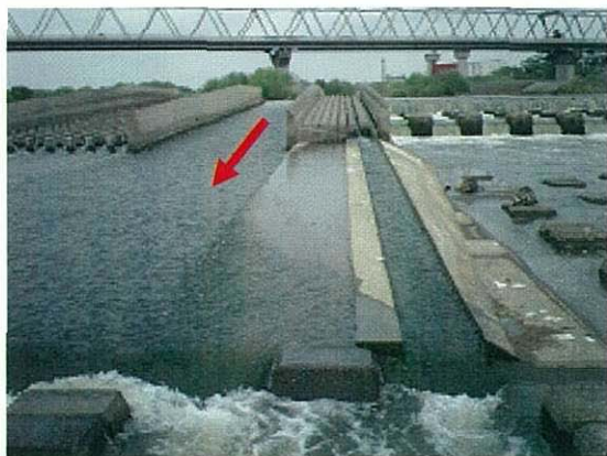
図3 右岸魚道の流況
