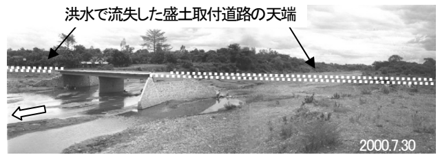
写真-1 ニカラグア国道24号線エル・ガジョ橋の被災状況
