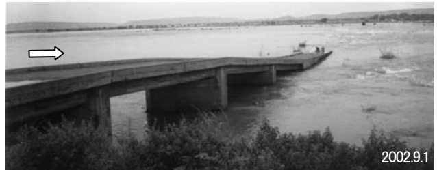
写真-11 同上潜り橋で、雨季に越流されている様子
