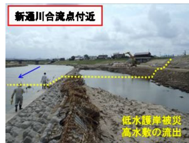
写真-1 五十嵐川下流左岸の高水敷被災(図-3参照)
