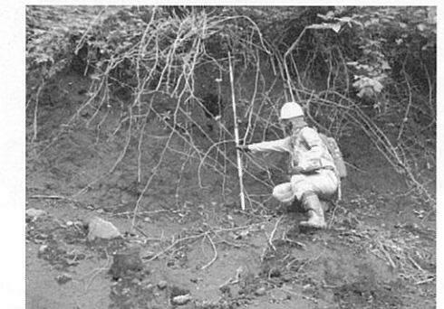
写真-11 表層崩壊源頭部のパイプ (古閑地区1)
