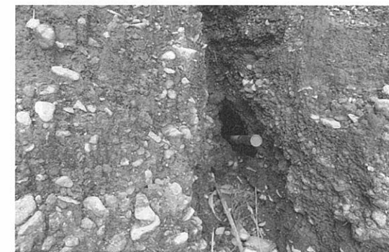
写真-2 三久保地区の崩壊 崩壊全景と砂礫層中に見られるパイピングホール (北緯 32° 57' 59.2", 東経 131° 1' 46.1")
