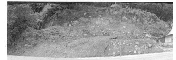
写真-12 斜面崩壊の例 (古閑地区2)
