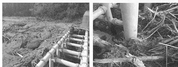
写真-19 左：D-4 堆砂状況 右：D-4 閉塞状況
