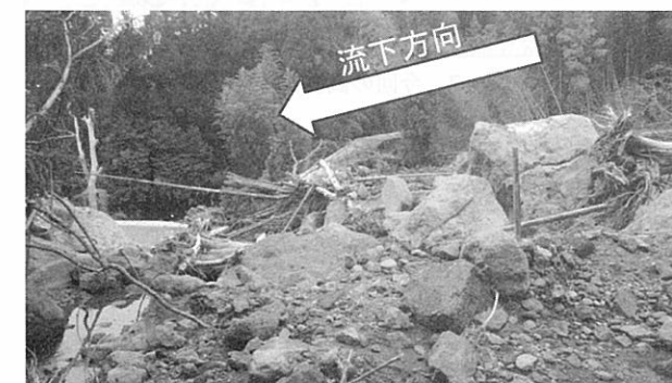
写真-18 塩井川砂防堰堤上流に堆積した土砂
