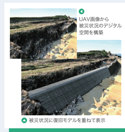
デジタル技術を活用した被災状況や災害復旧の可視化
