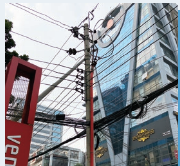
ダッカ市中心街の配電線
