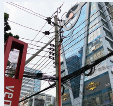
ダッカ市中心街の配電線
