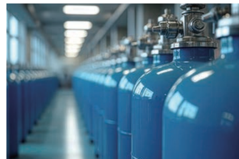
巨大なガスボンベ
