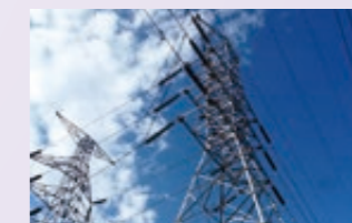
ウガンダ国クィーンズウェイ変電所鉄塔
