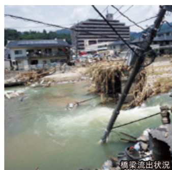
橋梁流出状況
