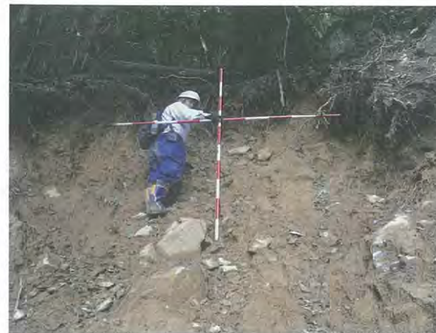
写真-7 五反田川の源頭部の崩壊状況
