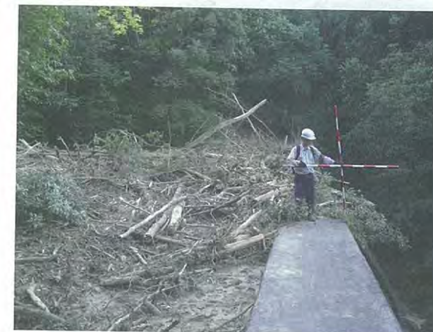
写真-18 根谷川支川85の治山堰堤の堆砂状況
