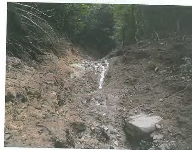
写真-4 根谷川支川 85 の流下域に見られる花崗岩亀裂部からの湧出
