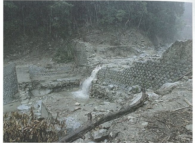
写真-13 石積堰堤の破損状況 Photo 13 Damage in masonry dam
