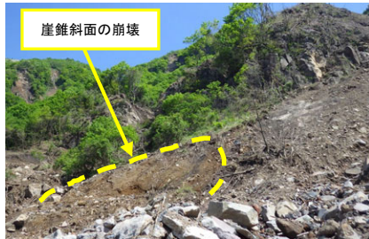
図-4 斜面脚部の崖錐堆積物の崩壊（上の小屋川2）
