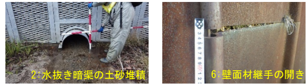
図3 確認された変状(例)
