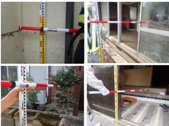
写真-1 浸水痕跡事例(上段:外壁に付いた痕跡 下段左:植生に付いた痕跡 右:浸水染みによる痕跡)
