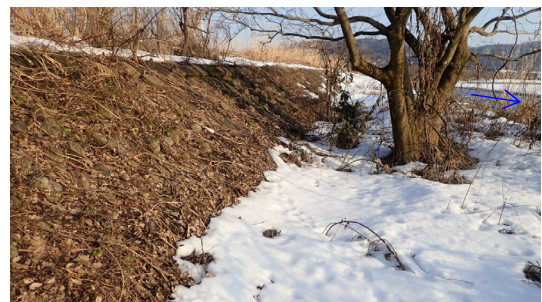
図-23 照査対象護岸② 低水護岸の状況 (令和3年1月27日 現地調査結果)
