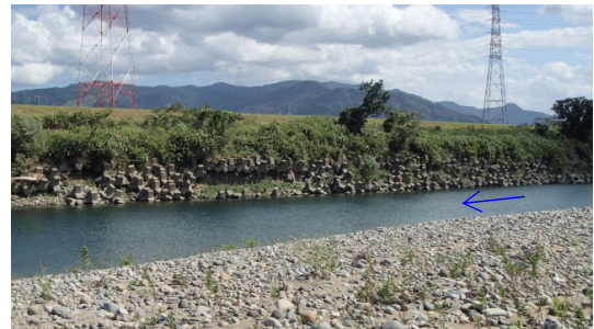
図-21 照査対象護岸② 根固め工の沈下状況 遠景 (令和2年9月8日 RiMaDIS巡視記録より)
