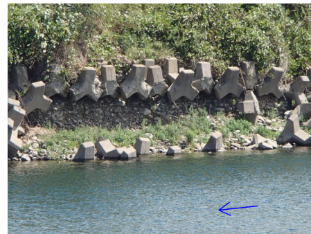
図-22 照査対象護岸② 根固め工の沈下状況 近景 (令和2年9月8日 RiMaDIS巡視記録より)
