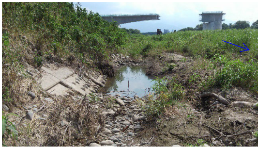
図-18 照査対象護岸① 護岸前面洗堀時の状況 (平成30年7月24日 RiMaDIS巡視記録より)
