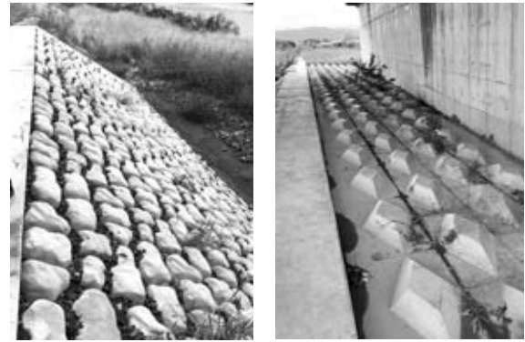
(a) 低水護岸根固め工(自然石系) (b) 低水護岸根固め工(コンクリート)
