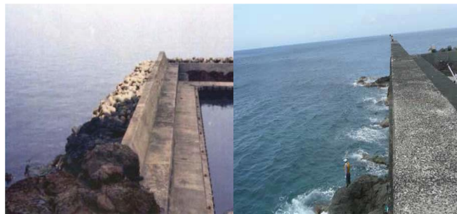
写真-1 被災前（左）および被災後（右）の状況
