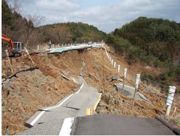
写真1 能登有料道路の盛土崩壊 3) (H19能登半島地震)
