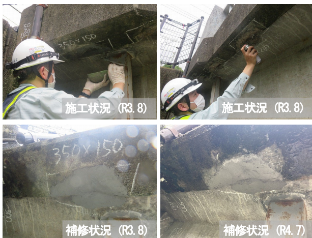
図-7 定期点検時の簡易補修
