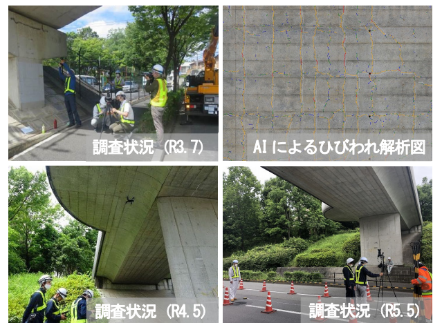
図-8 画像計測とAIによるひび割れ解析
