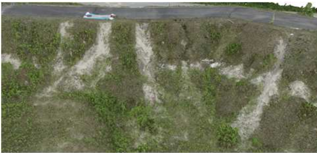
図8 法面の変状（UAVによる評価）
