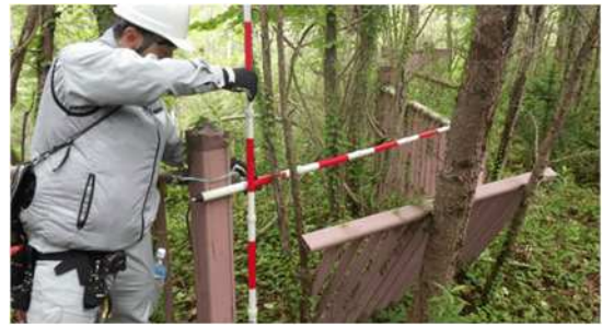
図9 安全柵の破損（目視による評価）
