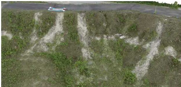
図 2 法面の変状（UAV による確認）
