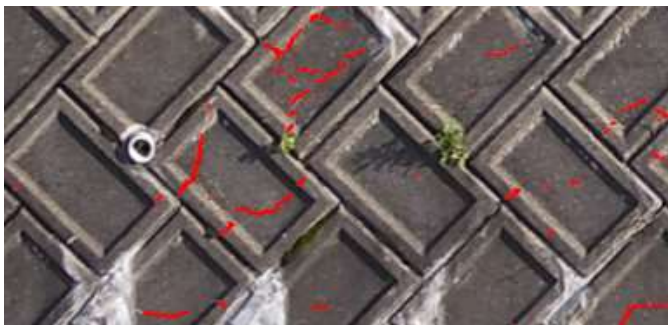
図1 コンクリート護岸のひび割れ検出結果
