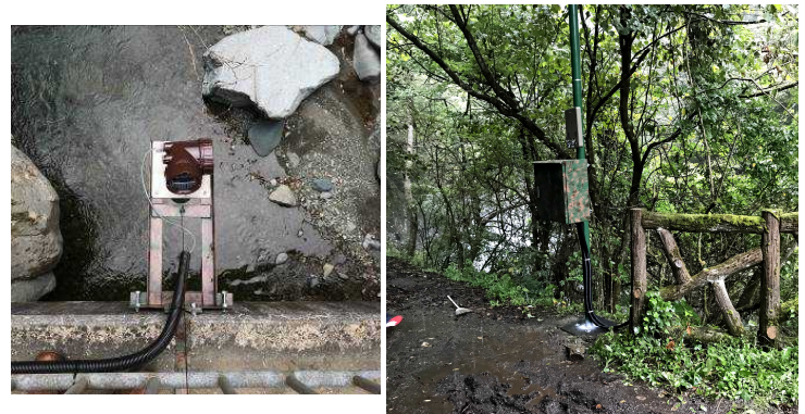
図-4 水位計設置状況(塩水橋)
