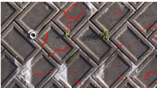
図-2 河川のコンクリート護岸のひび割れ検出結果
